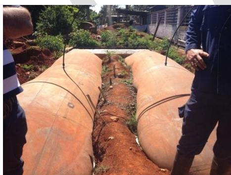
Foto 3. Biodigestor tubular de EPDM, de fabricación nacional, ubicado en la C.S.S.F Vicente Pérez Noa
