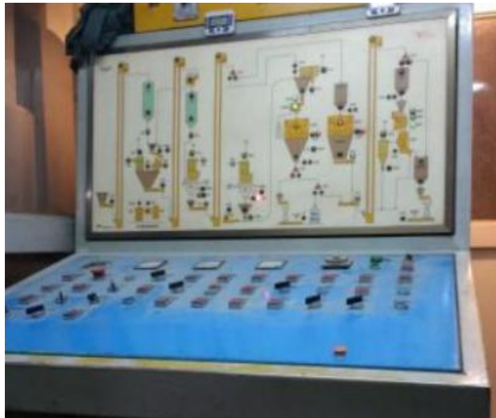
Ilustración 41 - Tablero de comando principal
