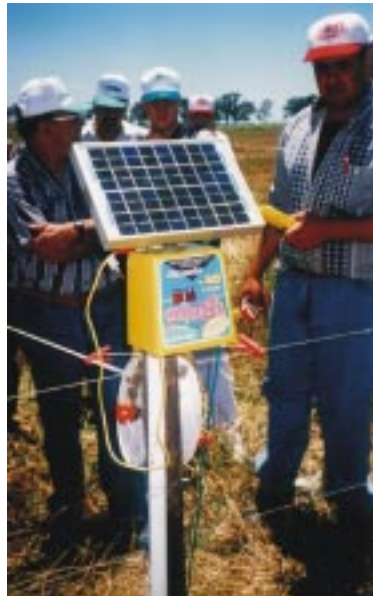
Los Paneles Solares han solucionado el problema del recambio de baterías.
